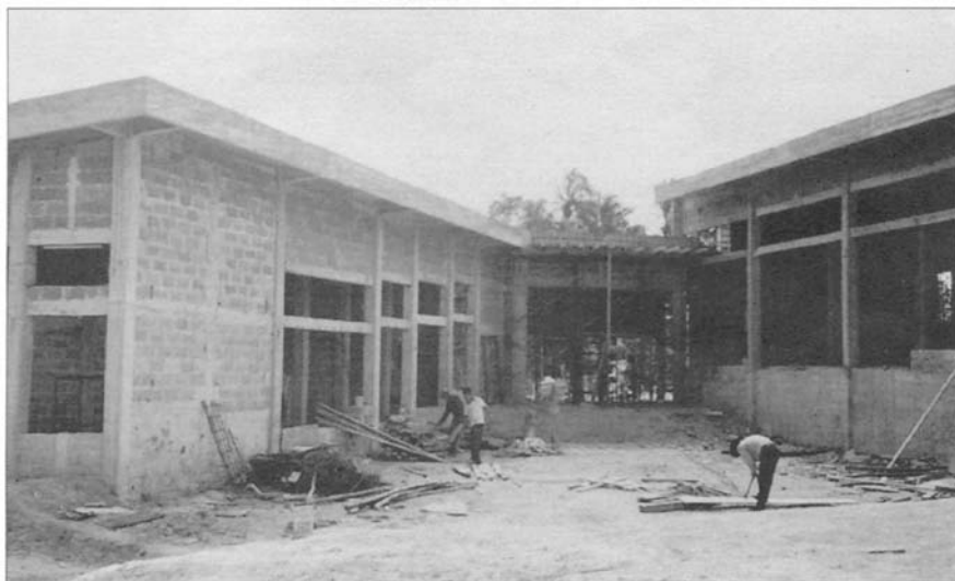
Edificio en construcción de la Biblioteca Pública de Tamulté de las Sabanas. Primera etapa.
